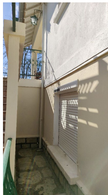
Le panneau est positionné devant un mur = NON CONFORME
